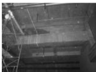
图2 號都花园地下车库治理前渗漏情况
