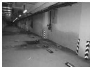
图4 智雅茗苑地下车库治理前渗漏情况
