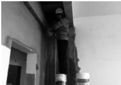
图 4 顶面涂刷裂纹渗漏一涂灵
