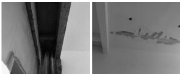
图1 顶板出现裂缝渗漏
